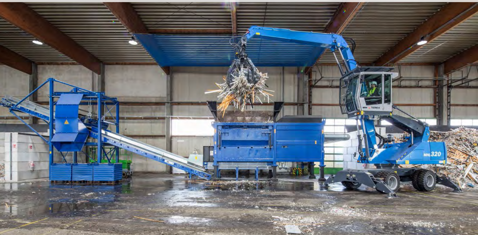
In der Anlage können glasfaserverstärkte Verbunde (z. B. ausgediente Rotorblätter und GFK-Produktionsrückstände) aufbereitet werden.
